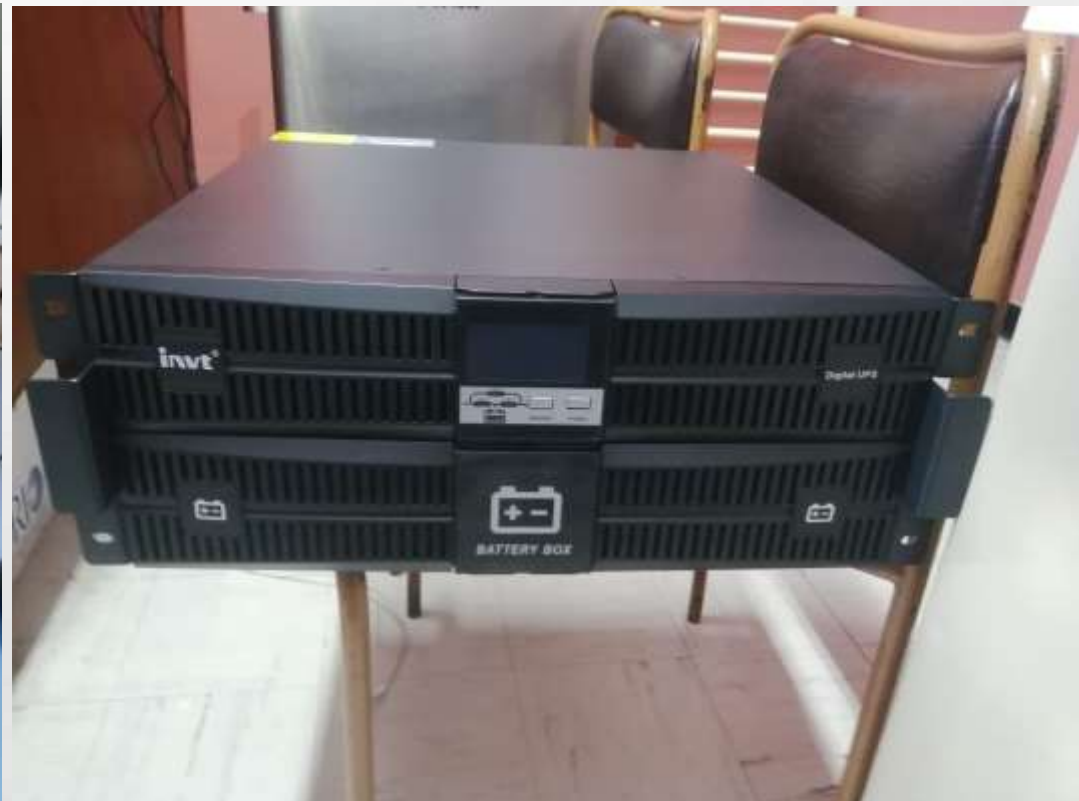
UPS MARCA INVT POWER SYSTEM
